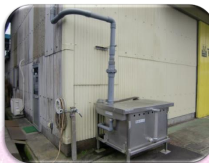
雨水タンク2号機
